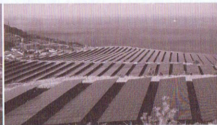
【太陽光発電所】
